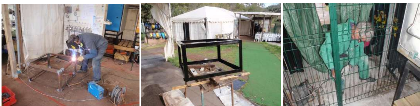
Un poteau supplémentaire est posé sur la clôture séparant l'installation des combinaisons pour supporter le tableau de gonflage 300 bars.
